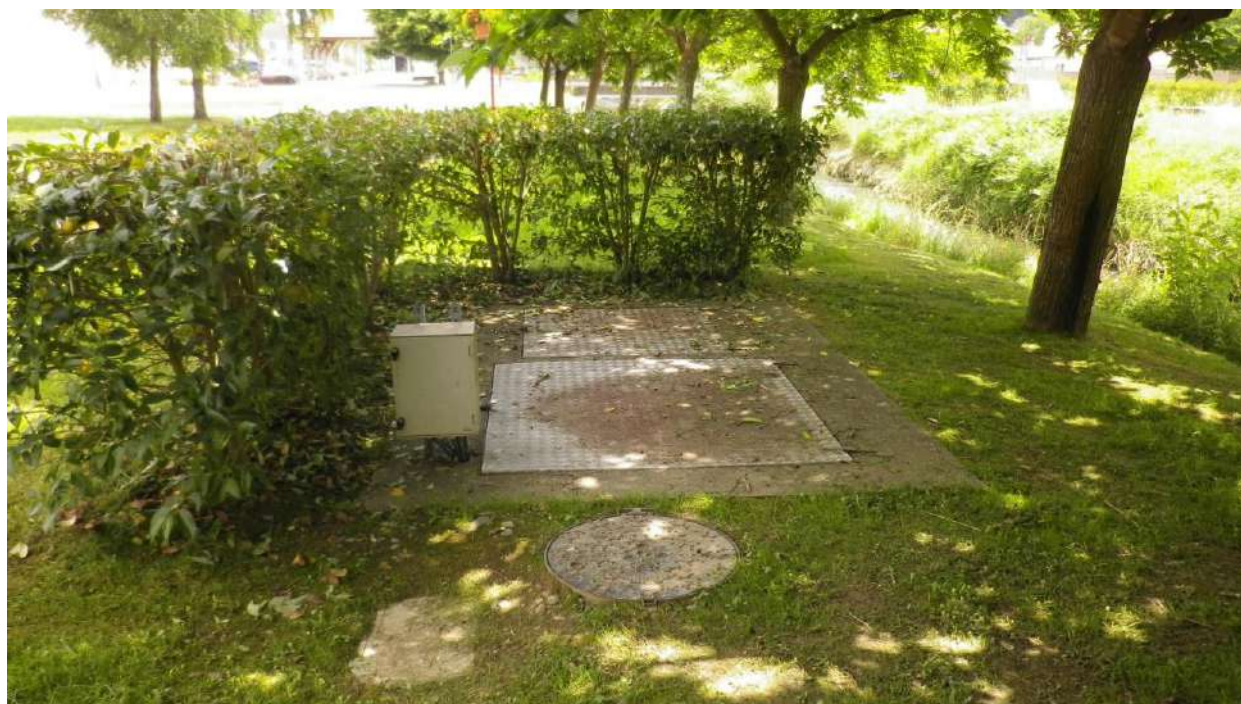
Figure 8 : Photo du poste de refoulement du Clos de la Rivière
