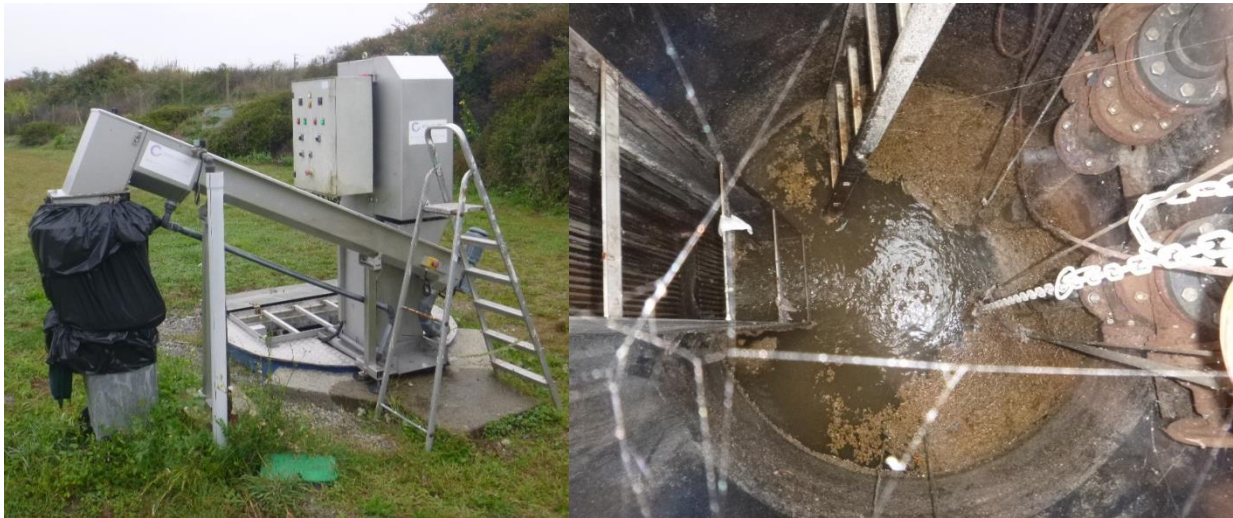
Figure 8 : Photos du poste de relevage de la STEP
