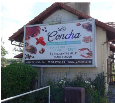
Structure épaisse masquant un montage anormal
