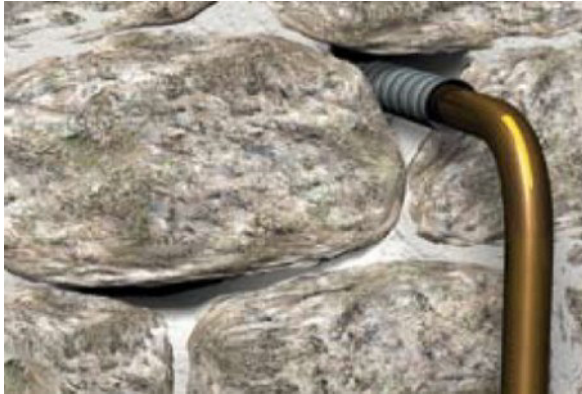
Situation initiale avant colmatage
