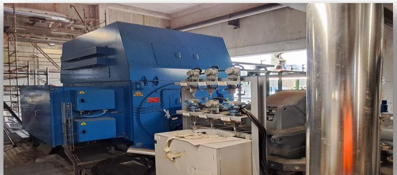
Turbo-alternateur produisant l'électricité après la turbine de l'UVE
