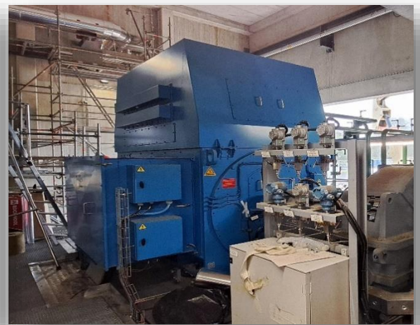
UVE de Lescar Groupe Turbo Alternateur produisant l'électricité revendue sur le réseau public
