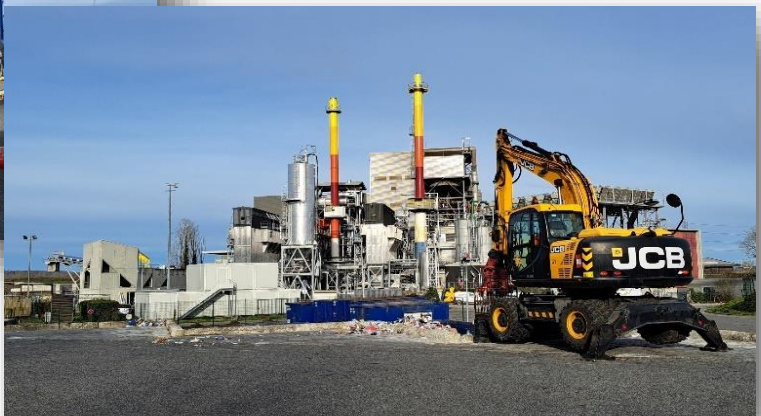
Quai de transfert de Capécologia et vue de l'UVE à Lescar
