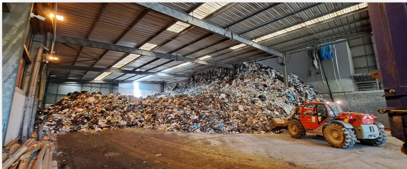
Fosse de réception des déchets et quai à l'UVE de Lescar fin 2023 avec un stock de déchets importants lors d'arrêts techniques pour les derniers travaux sur le GTA.
