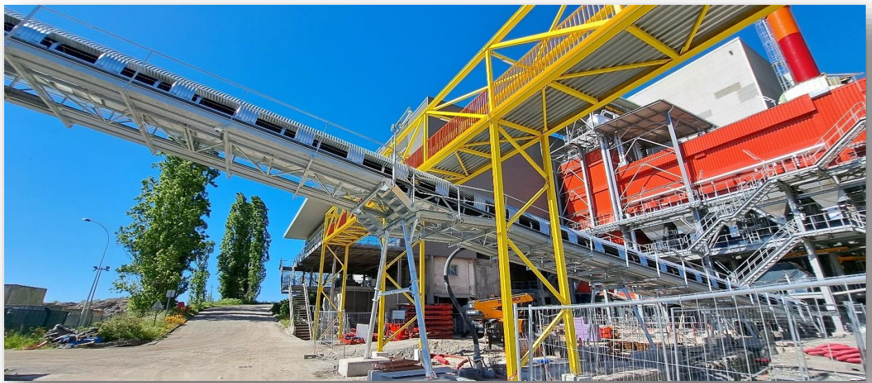
Passerelle entre les locaux sociaux et l'usine et convoyeur d'amenée des graves de mâchefers d'incinération
