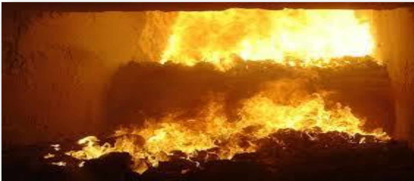
Intérieur d'une des lignes d'incinération
