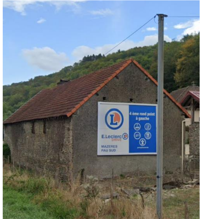
Laroin (dépassement de l'égout du toit)
