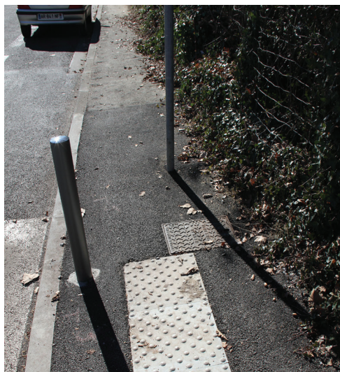
Il est nécessaire de penser «chaîne de déplacement» exemple d'une traversée piétonne en conformité PMR, mais cheminement non conforme sur trottoir Pau
