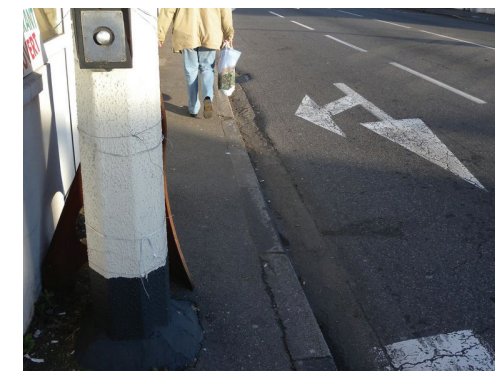
Largeur de cheminement piéton non réglementaire (passage impossible (poussette, UFR, etc.) sans descendre sur la chaussée automobile) Pau
