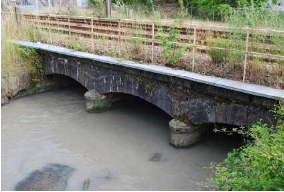
Les ouvrages d'art et ses matériaux. Pont sur le canal Héid, chemin de fer.
