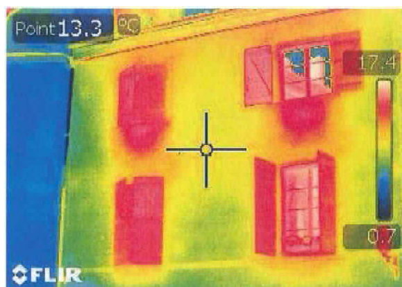
Clichés de thermographie réalisés en hiver par le cabinet Fébus Eco-Habitat. Mise en évidence des déperditions thermiques des fenêtres et de leurs allèges. L'allège est un point important du mur à isoler
