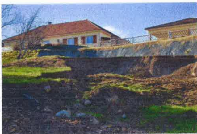
Le gros glissement venant du Pic d'Orhy, non stabilisé encore à ce jour et impactant les parcelles citées dans le courrier qui sont encore en UBC. Depuis 2015 il est évolution constante
