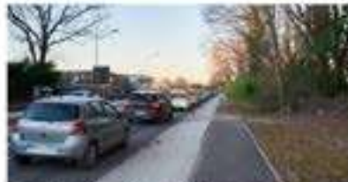
Construction actuelle à l'épave de la giratoire Nobel sur le nouveau passage
