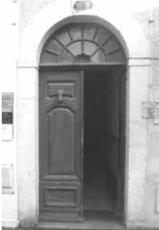
Type de menuiserie de porte à deux battants en bois à moulure et peint. Imposte vitrée et heurtoir en fonte. Place Saint Louis de Gonzague
