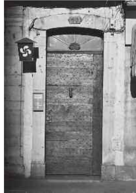
Type de menuiserie de porte à un battant en planches et contre-planches, en bois peint. Imposte vitrée et heurtoir en fonte. Rue Maréchal Joffre
